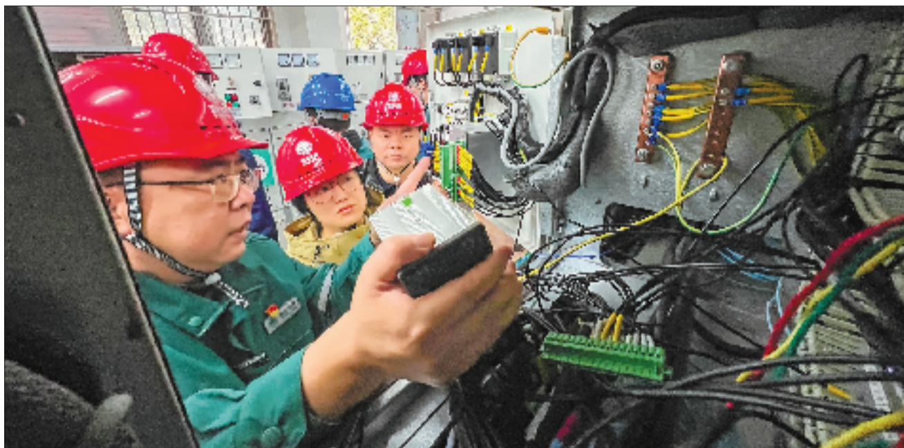
张霁明(左一)介绍开关柜微机保护装置。
