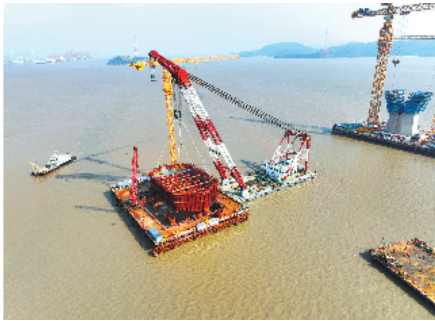
12月3日,宁波舟山港六横公路大桥最后一个钢箱顺利下放,全线正式进入海上施工阶段。该大桥建成通车后,将有力促进宁波舟山港梅山、六横两大核心港区及临港产业发展。
