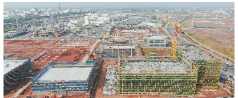
浙江拓烁光学新材料有限公司二期项目建设现场 周毅辉 摄
