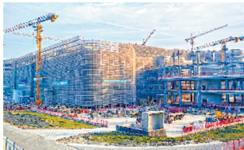
建设中的杭州市第一人民医院新院区 (图片由杭州市建委、杭州市地铁集团提供)
