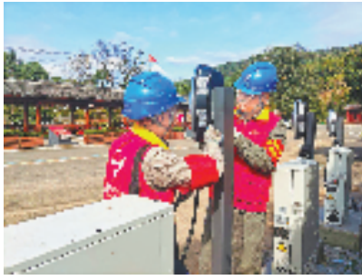
10月31日,国网平阳县供电公司员工在革命老区山门镇大屯村对新投运的充电桩设备做安全“体检”。 许伊蕾 摄
