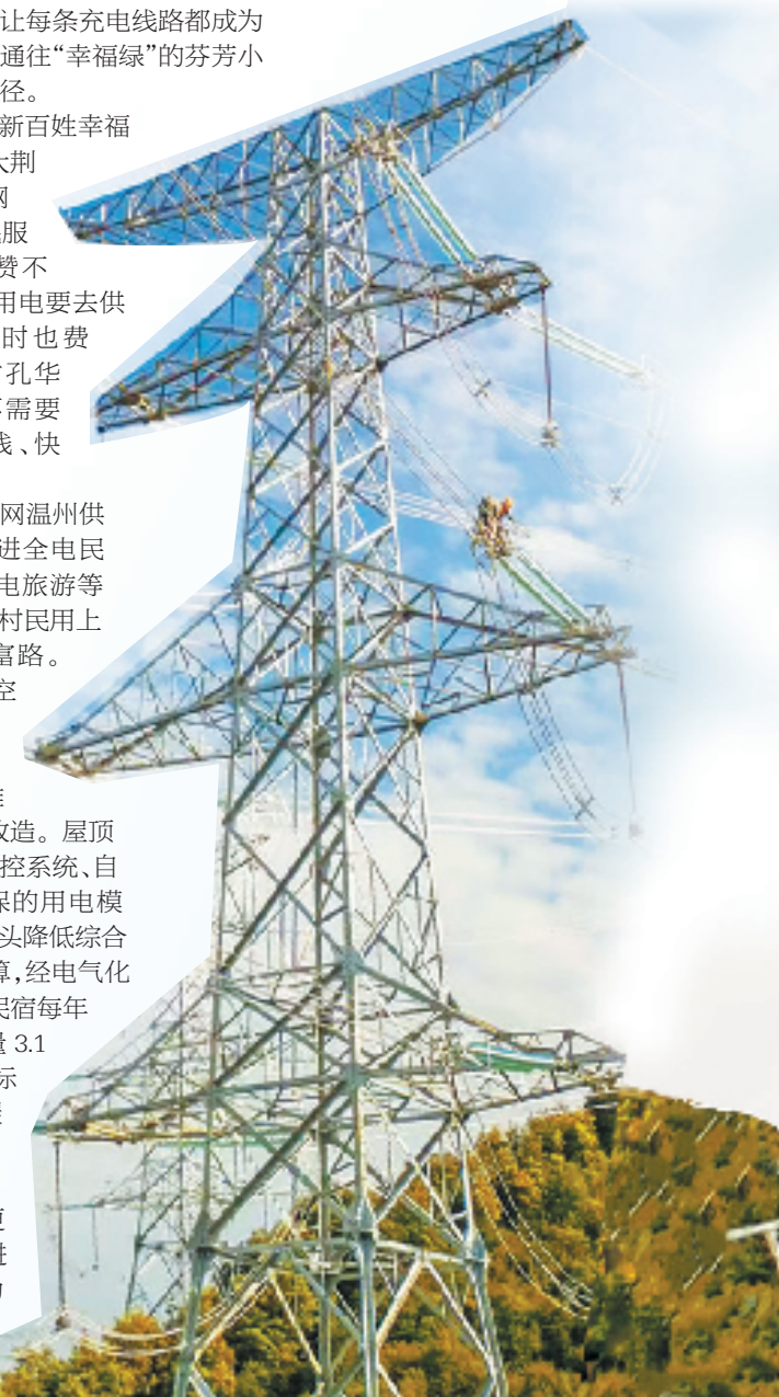
三澳核电500千伏送出工程第一阶段竣工验收
