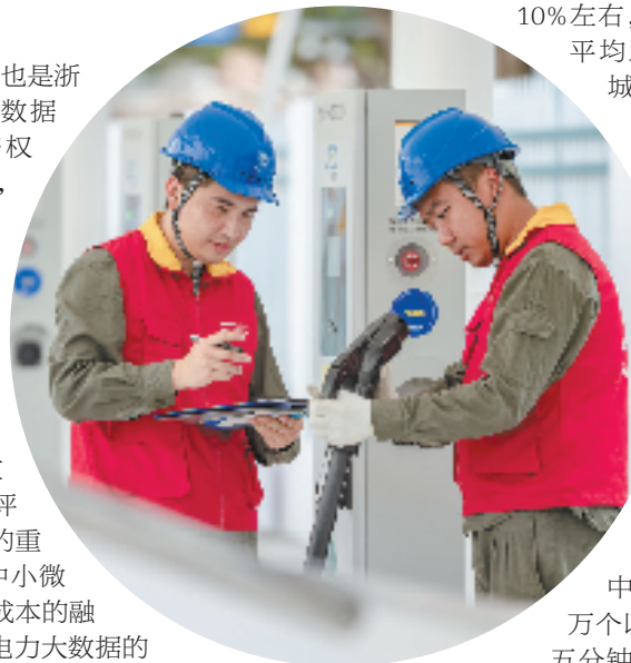
在洞头百岛光伏储能充电站调试充电桩 黄周虎 摄
