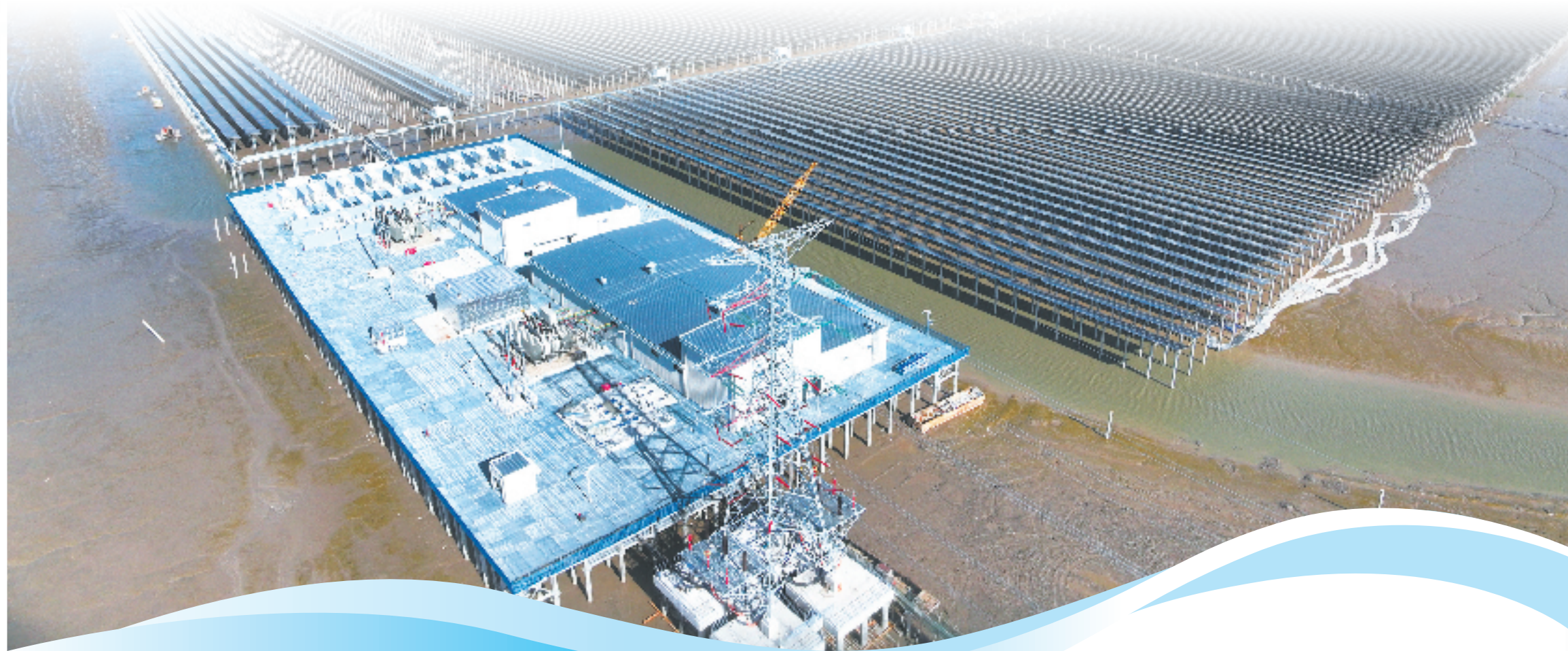
乐清湾亨泰550兆瓦渔光互补发电项目成功并网发电 黄慧慧 摄
