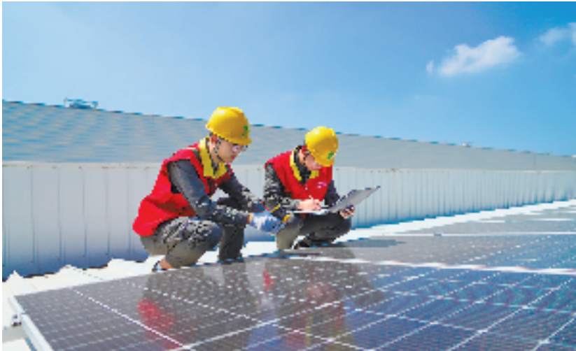
德清供电工作人员正在明德精密机械进行企业屋顶分布式光伏电站并网前检查。
