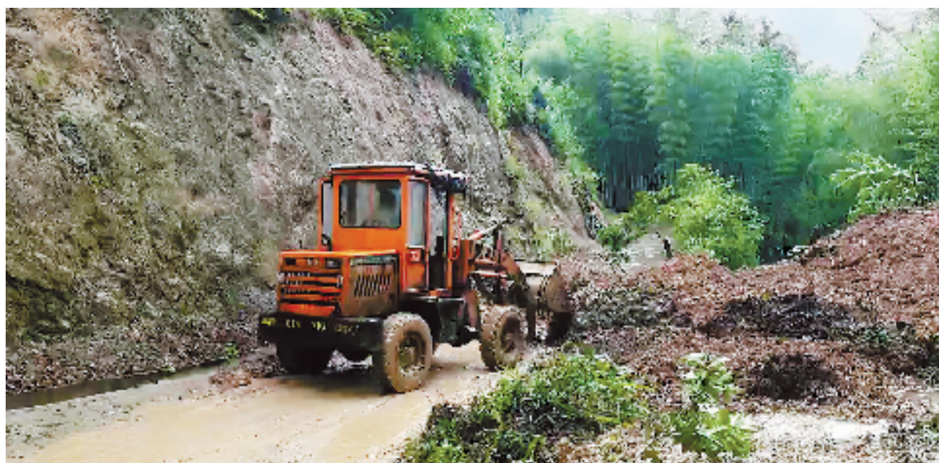
村民吴顺国开着铲车清理塌方的土石。
