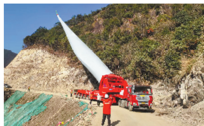
今年4月,庆元百花岩风电场项目进场道路上,工作人员正在指挥风叶片运输。
