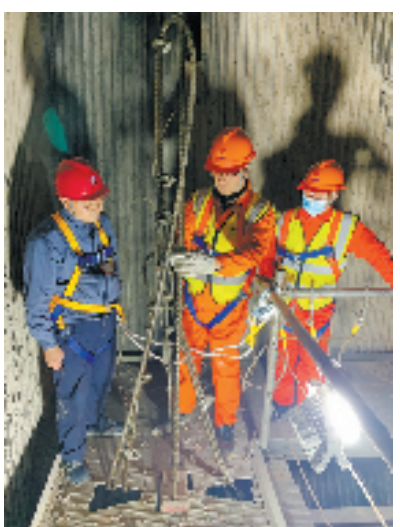
省特科院检验人员对电厂锅炉炉膛检修升降平台进行检查(图片由浙江省特种设备科学研究院提供)
