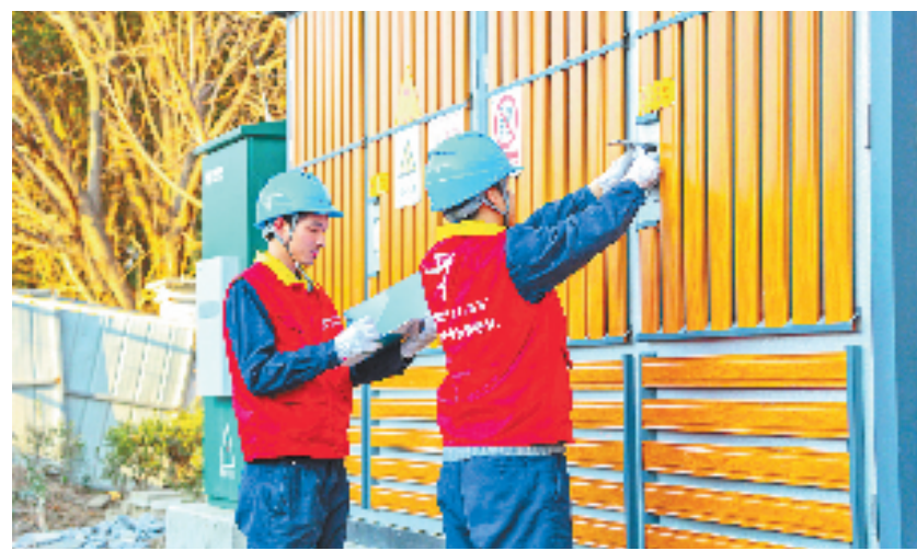
嘉兴市首套“光储智”一体化户外环网箱在海盐挂网运行现场 沈丽学 摄
