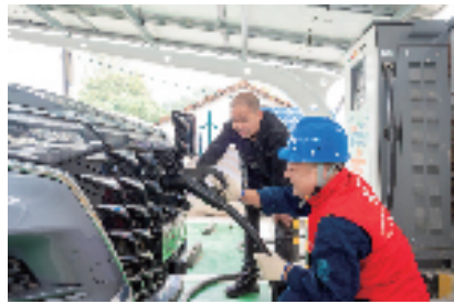
在金东区赤松镇北山口村“光储充”一体化充电站，电力工作人员为来充电的客户服务。 周宁 摄
