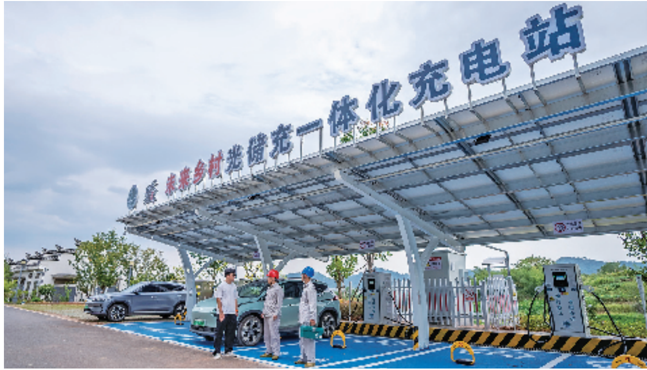
国网义乌市供电公司工作人员在李祖村未来乡村“光储充”一体化充电站，对站内充电桩进行逐项检查，确保充电设施安全、正常运行，为新能源汽车车主提供优质电力服务。 陈姣姣 摄
