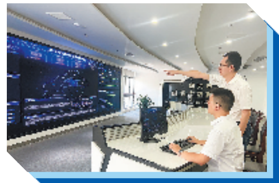
嘉兴市智慧能源监管平台
