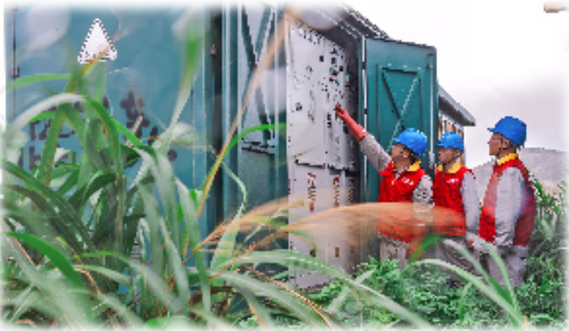
7月11日，红船共产党员服务队利用台风登陆前的最后窗口期，在头门岛对岛上环网柜进行再排查。 程梦珏 摄
