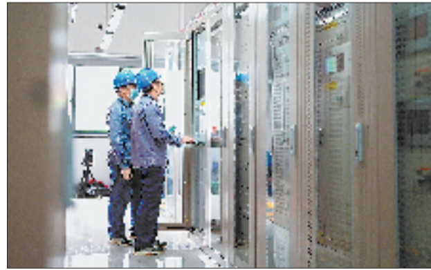
110千伏产业变投运前夕,运维人员对站内配电设备开展细致巡检,逐项核查设备运行参数,全力保障变电站顺利投运。 吴文涛 摄
