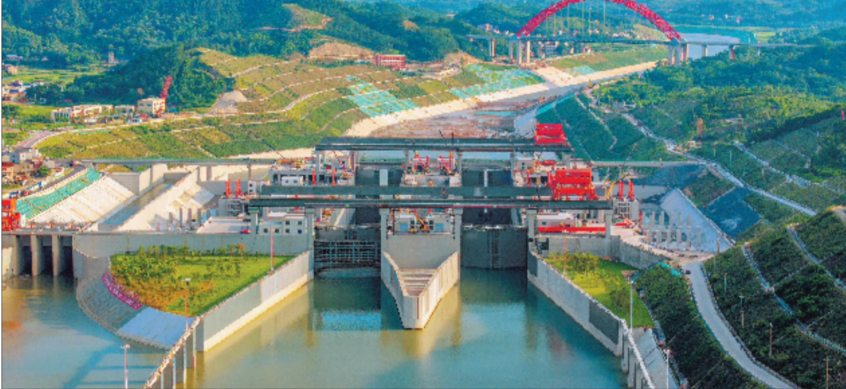
这是6月3日拍摄的广西平陆运河马道枢纽充水现场(无人机照片)。
