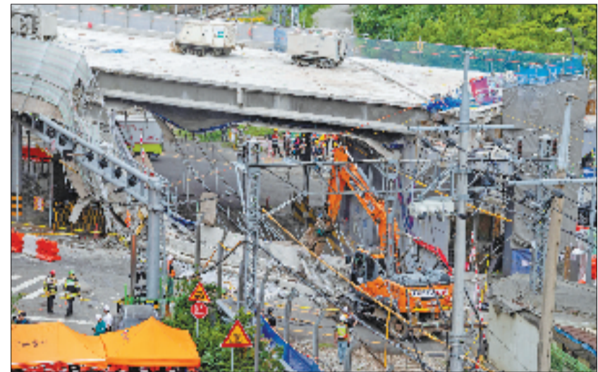
这是5月26日在韩国首尔拍摄的高架桥坍塌的事故现场。新华社发(全休相 摄)
