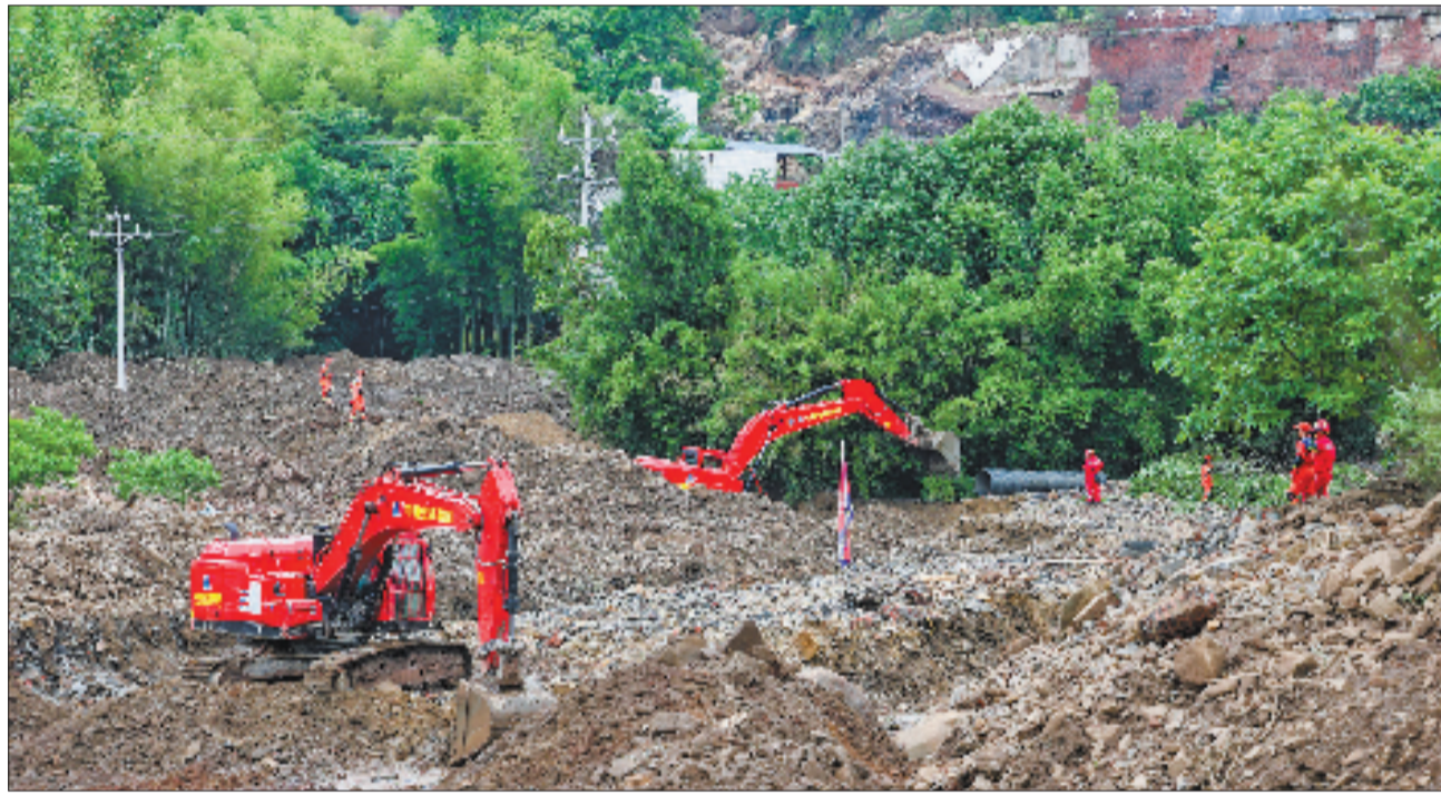
5月26日,救援人员在重庆市永川区茶山竹海街道安溪村救援现场作业。5月23日夜间至24日凌晨,重庆市永川区突发极端特大暴雨引发山洪和地质灾害。新华社记者 黄伟 摄
