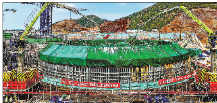
4月4日，位于宁波象山的金七门核电2号机组核岛第一罐混凝土浇筑启动，标志着该机组建设全面进入主体施工阶段。目前，金七门核电一期工程2台机组均已进入建设阶段，计划分别于2030年、2031年投产发电。本报记者 吕之遥 俞碧寅 应磊 通讯员 闫云龙 摄
