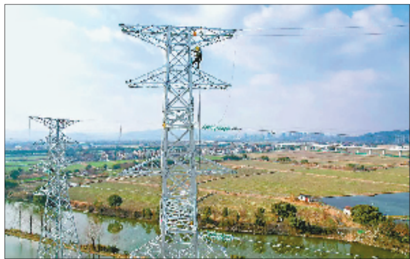
电网工作人员正在全力保障沿线电路运行安全 国网湖州供电公司供图
