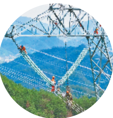
9月4日,缙云抽蓄500千伏送出工程磐安段施工现场,巍峨耸立的铁塔矗立在连绵起伏的山峦之间。
