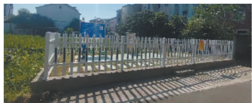
张家门生活污水治理设施 (图片由杭州市临平区崇贤街道提供)
