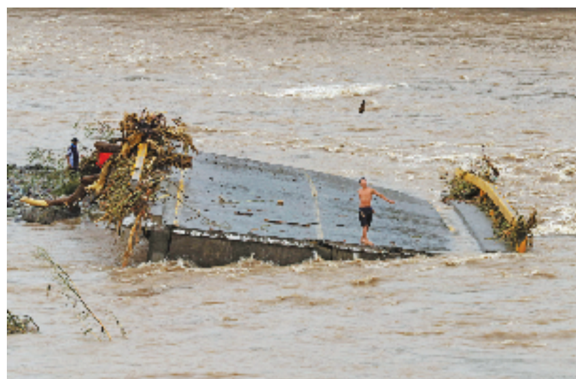
近日,洪都拉斯遭热带风暴“萨拉”侵袭。图为11月16日在洪都拉斯拉塞瓦拍摄的在热带风暴中受损的桥梁。 新华社发
