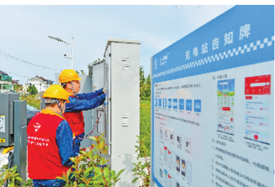
国网绍兴供电公司马鞍供电所工作人员来到柯桥区宝善桥村等地,对一批新投运电动汽车充电桩开展安全检查。 通讯员 高洁 摄
