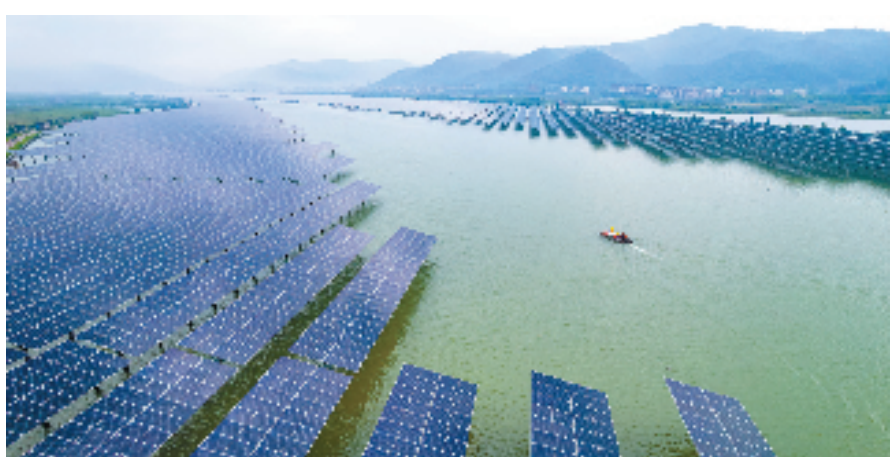
位于温岭的全国首座潮流互补智能光伏电站年平均发电量超1亿度，大幅优化了当地能源结构。 徐伟杰 摄
