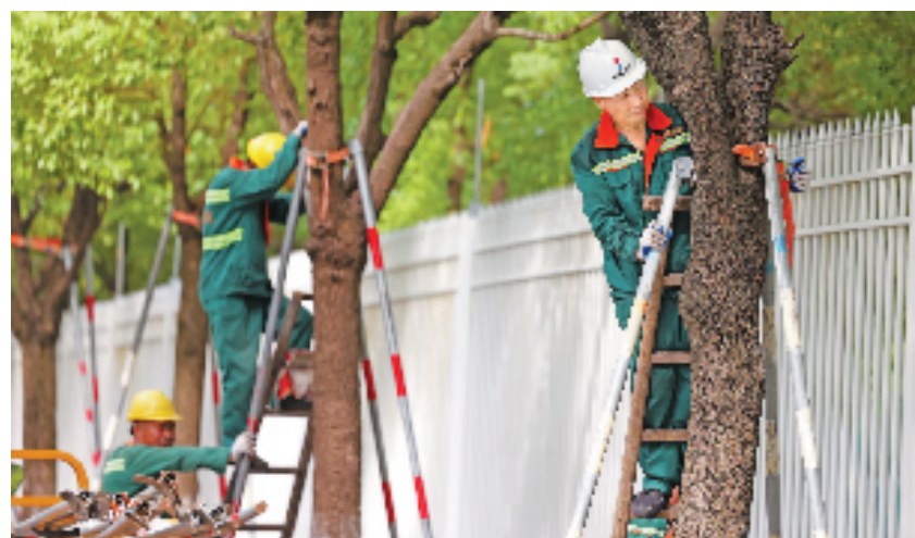
9月15日,为预防台风对钱塘江沿岸树木造成影响,杭州市滨江区工作人员对闻涛路沿线300多棵树木安装支撑杆进行加固。
