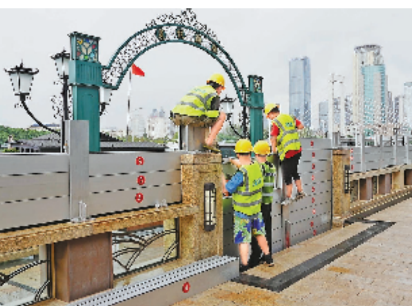
9月15日,为防止内涝危险,宁波市甬江堤防外滩段,工作人员正在安装防洪挡板。
