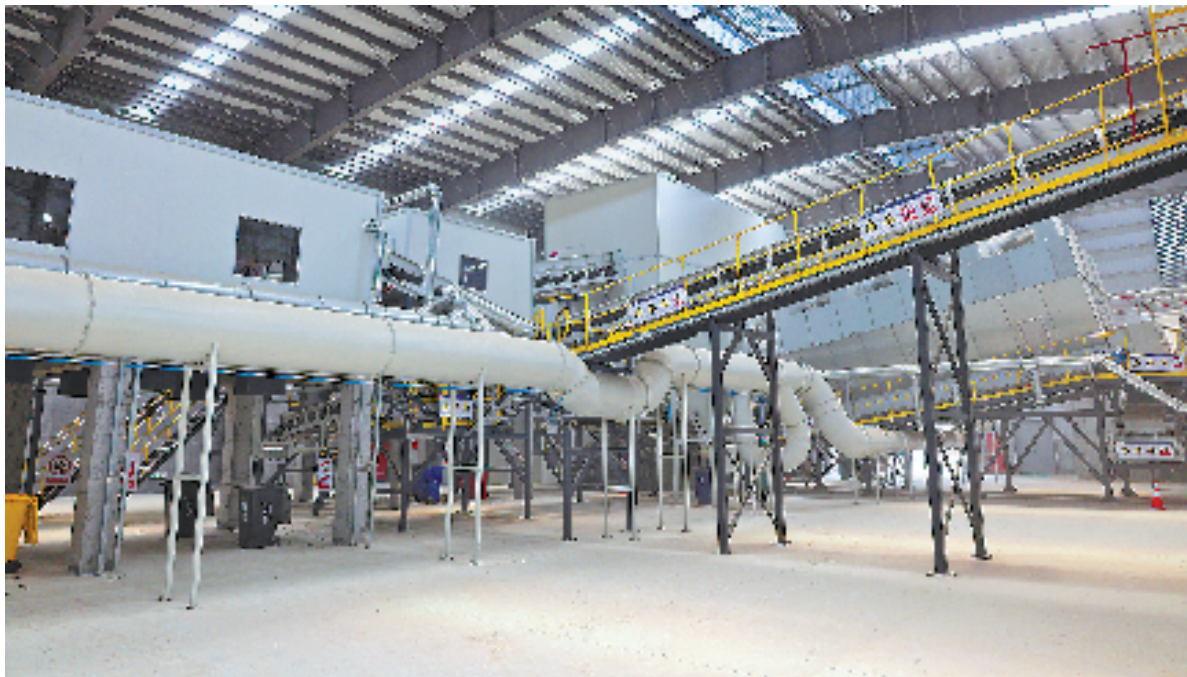
左图:开化县建筑垃圾综合处置厂的资源化利用生产线。右图:记者(左)分拣建筑垃圾中的杂质。
