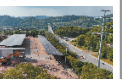
施工中的施家光储充换新能源综合供能站(图片由浙江建德经济开发区提供)
