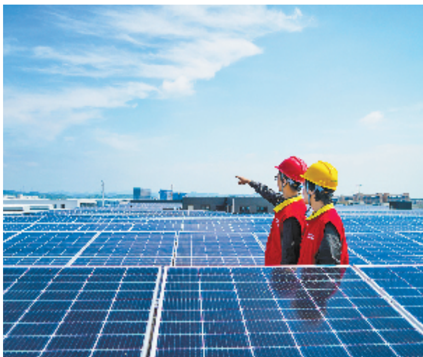
国网德清县供电公司工作人员协助企业检查屋顶光伏电站，推进企业屋顶光伏开发，促进清洁能源利用。
