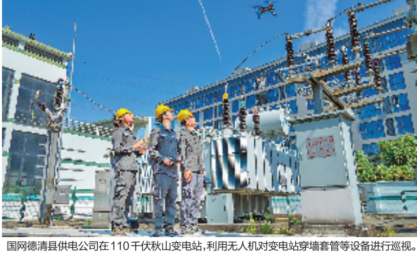
国网德清县供电公司在110千伏秋山变电站,利用无人机对变电站穿墙套管等设备进行巡视。
