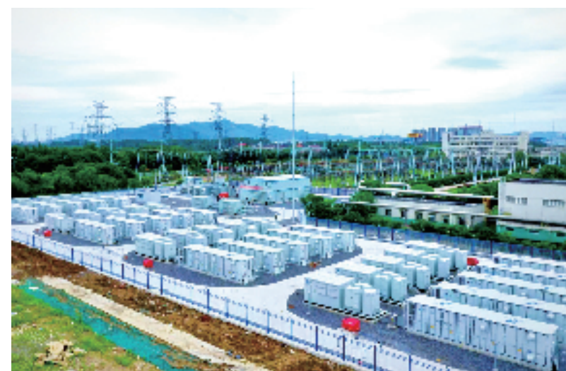
华能长兴储能示范项目 沙鹏 摄
