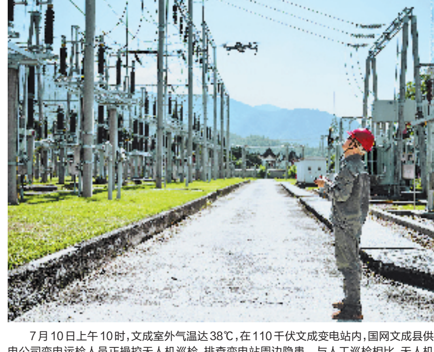
7月10日上午10时,文成室外气温达38℃,在110千伏文成变电站内,国网文成供电公司变电运检人员正操控无人机巡检,排查变电站周边隐患。与人工巡检相比,无人机巡检成本低、效率高、更安全。 本报记者 叶小西 共享联盟·文成 金中亮 王琪 文/摄
