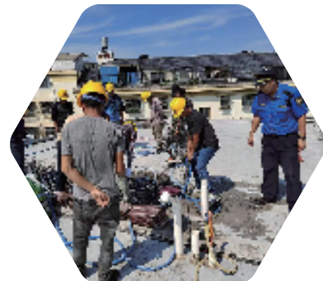
违建整治现场 义乌市江东街道供图
