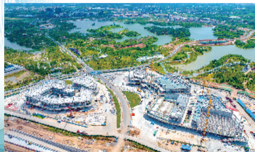
金义湖科技创新策源地全面拉开施工作业面，奋力跑出项目高效推进新速度。 胡赣昌 摄
