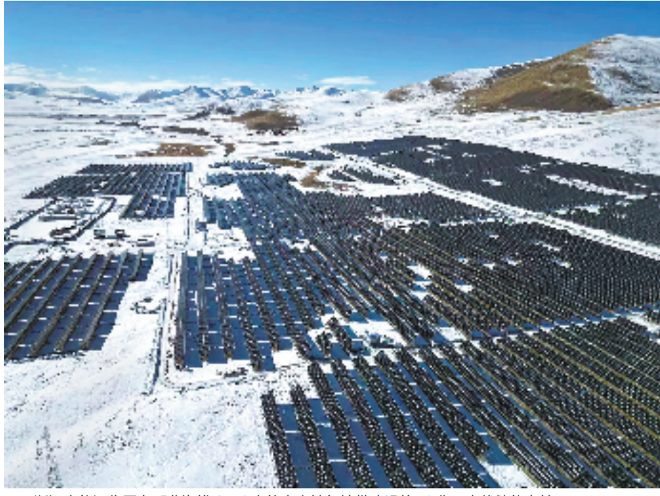
浙江省能源集团在那曲海拔4750米的高寒缺氧地带建设的50兆瓦光伏储能电站。浙江援藏指挥部供图
