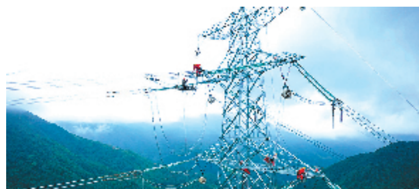
温州三澳核电500千伏一阶段送出工程施工现场 (图片由国网苍南县供电公司提供)
