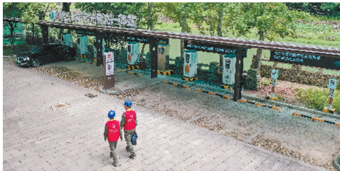
温州大岩若光储充一体站 叶温涛 摄
