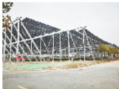
嘉兴市联合污水厂光伏发电项目现场 (图片由嘉兴水务集团嘉源生态环境有限公司提供)
