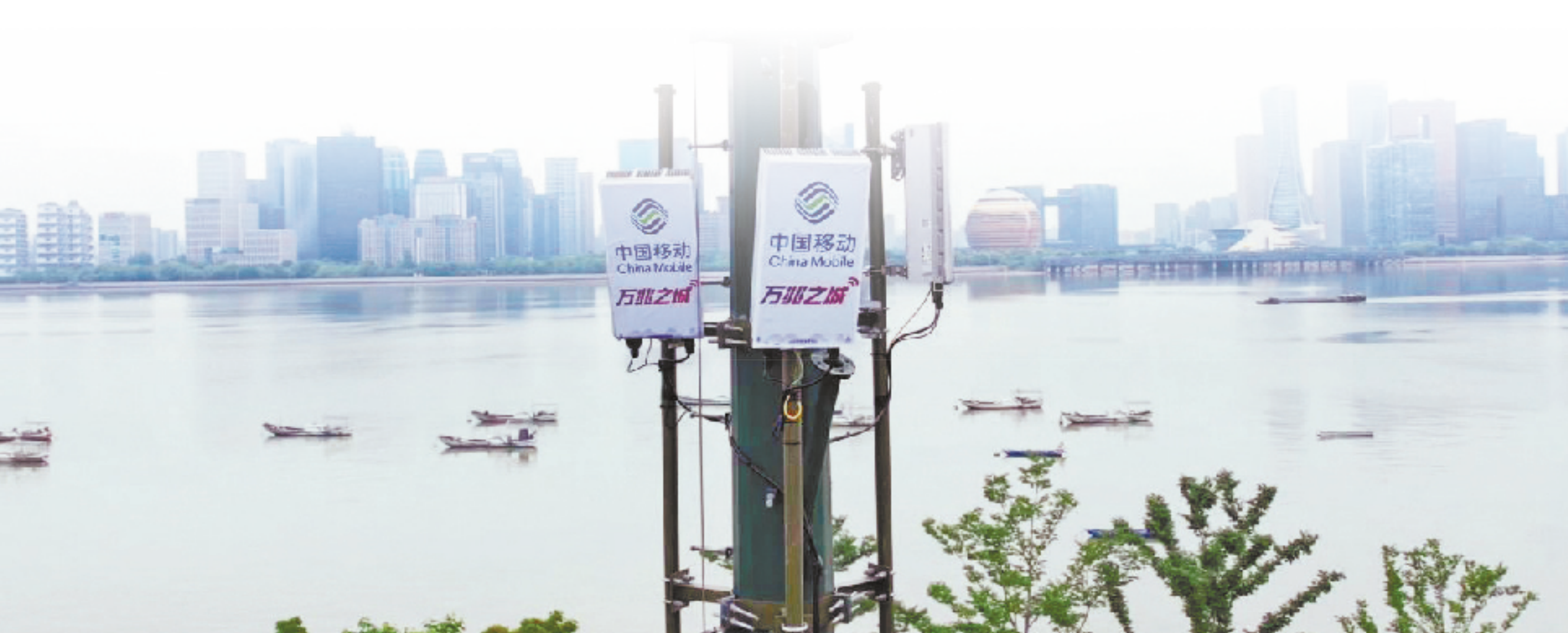
杭州已经形成了多个位置的5G-A连续组网覆盖,今年内将达到千站覆盖。
