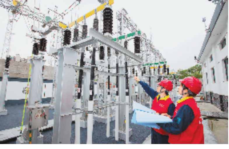
日前,杭温铁路220千伏牵引站及两条外部供电工程经过国网金华供电公司工作人员调试,通过验收。截至目前,杭温铁路金华段横店站、磐安站牵引站已全部完成投运,即将进入联调联试阶段。 拍友 陈冰冰 张梅 摄
