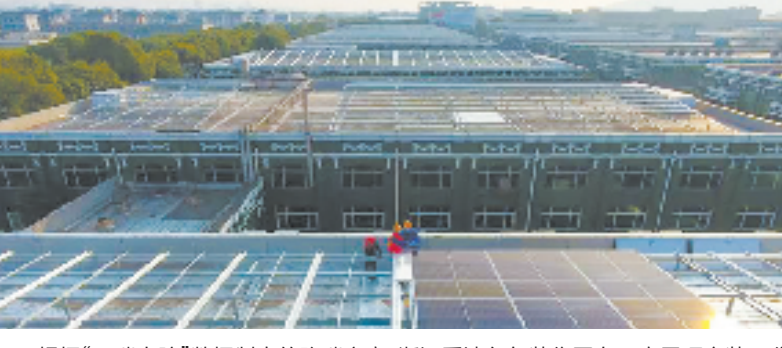
根据“双碳大脑”数据制定的降碳方案，浙江爱迪尔包装集团在厂房屋顶安装了分布式光伏项目。姚靖霖 摄
