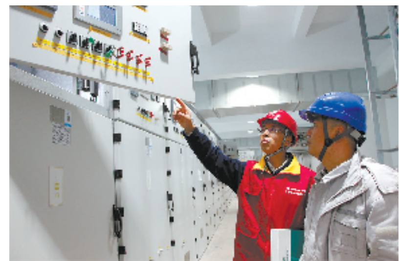
近日,在浙江鸿禧能源股份有限公司变电站内,国网嘉兴供电公司客户经理指导用户检查站内设备。(王徐燕 摄)
