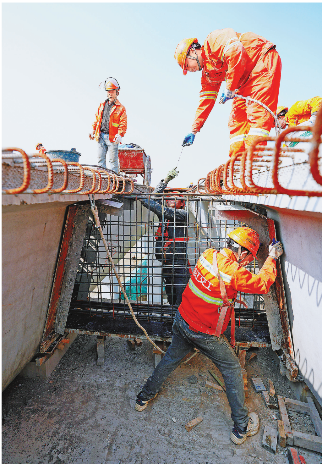
3月8日,位于苏台高速公路南浔至桐乡段及桐乡至德清联络线(二期)TJ02标段施工现场,工人们正有条不紊地作业。
