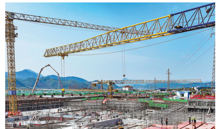
3月8日,在杭州市临安区天目未来谷生态研学城工程施工现场,一片忙碌的施工景象。
