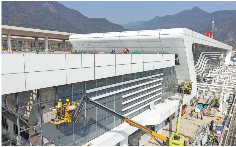
3月7日 在杭温高铁台州市仙居站项目施工现场,工人们正抢抓施工进度,确保工程如期完工。
