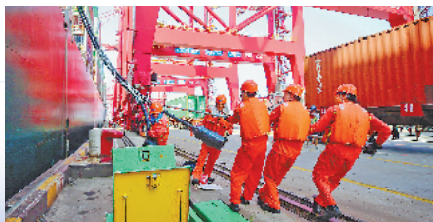
电力工人在宁波舟山港码头作业。 拍友 王幕宾 摄
