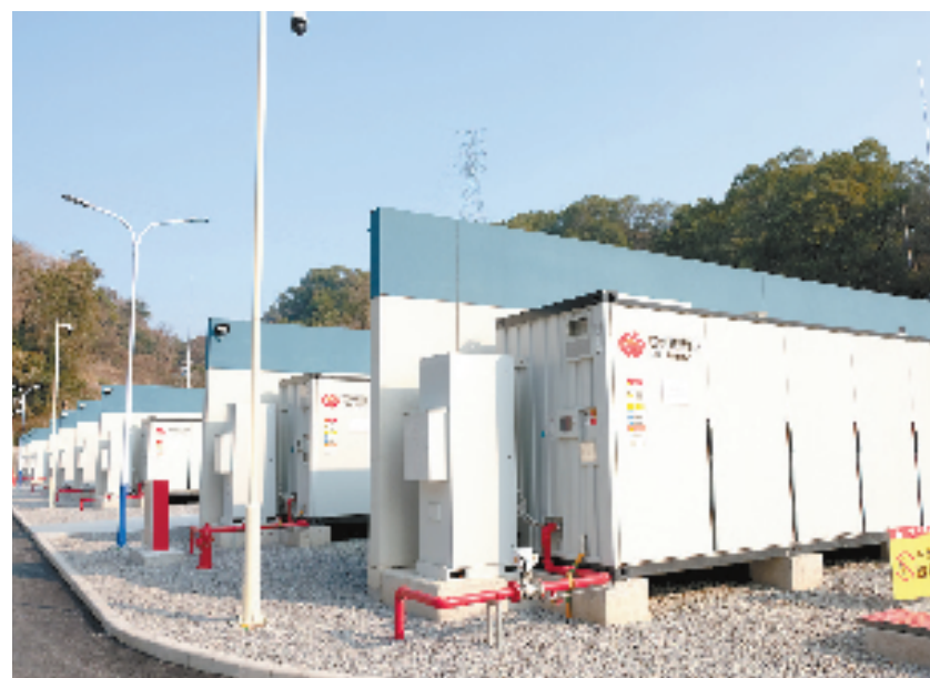
国能浙江温州梅屿储能电站全容量并网投运 叶斯斯 摄
