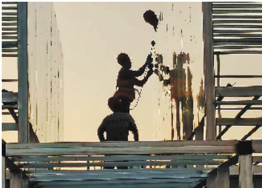
工人正在杭州市滨江区海威中心安装空调外机降噪装置。 拍友 励丰盈 摄
