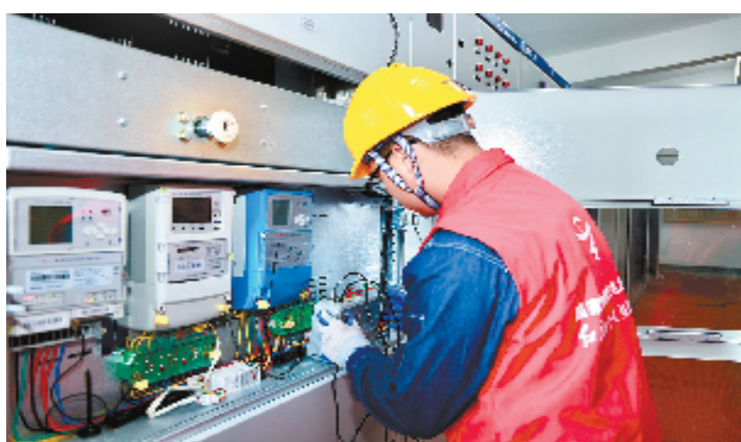
12月5日,国网绍兴市上虞区供电公司工作人员正在对新建小区开展户表关系核查工作。(图片由国网绍兴市上虞区供电公司提供)
