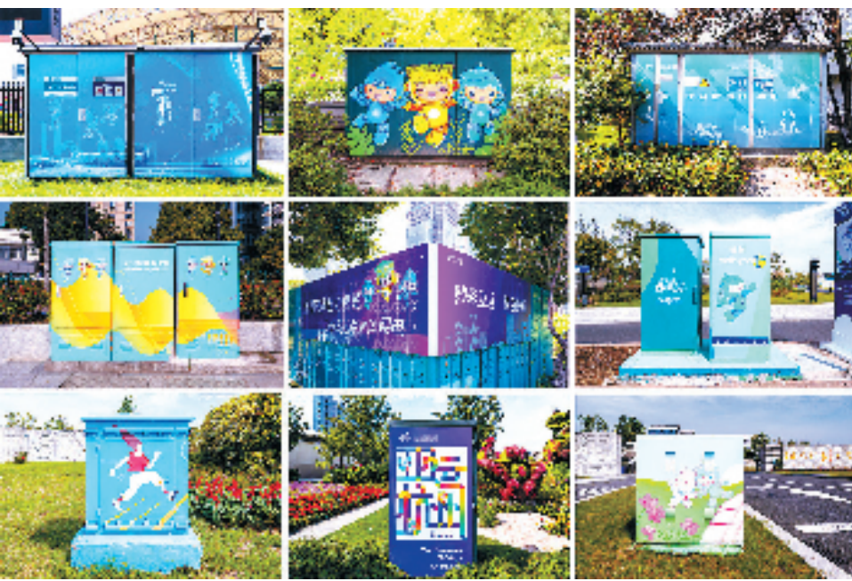
《变电箱的亚运元素》 陈伟 摄
