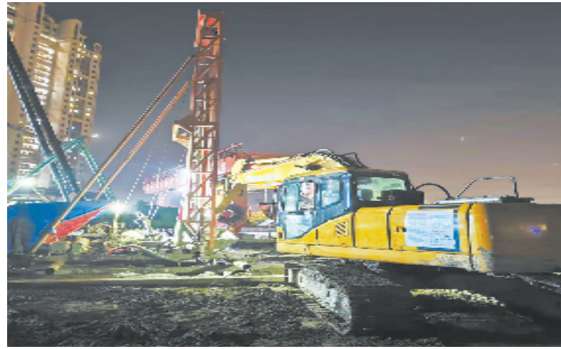
宁波市轨道交通8号线一期工程夜间施工现场(图片由鄞州生态环境局提供)
