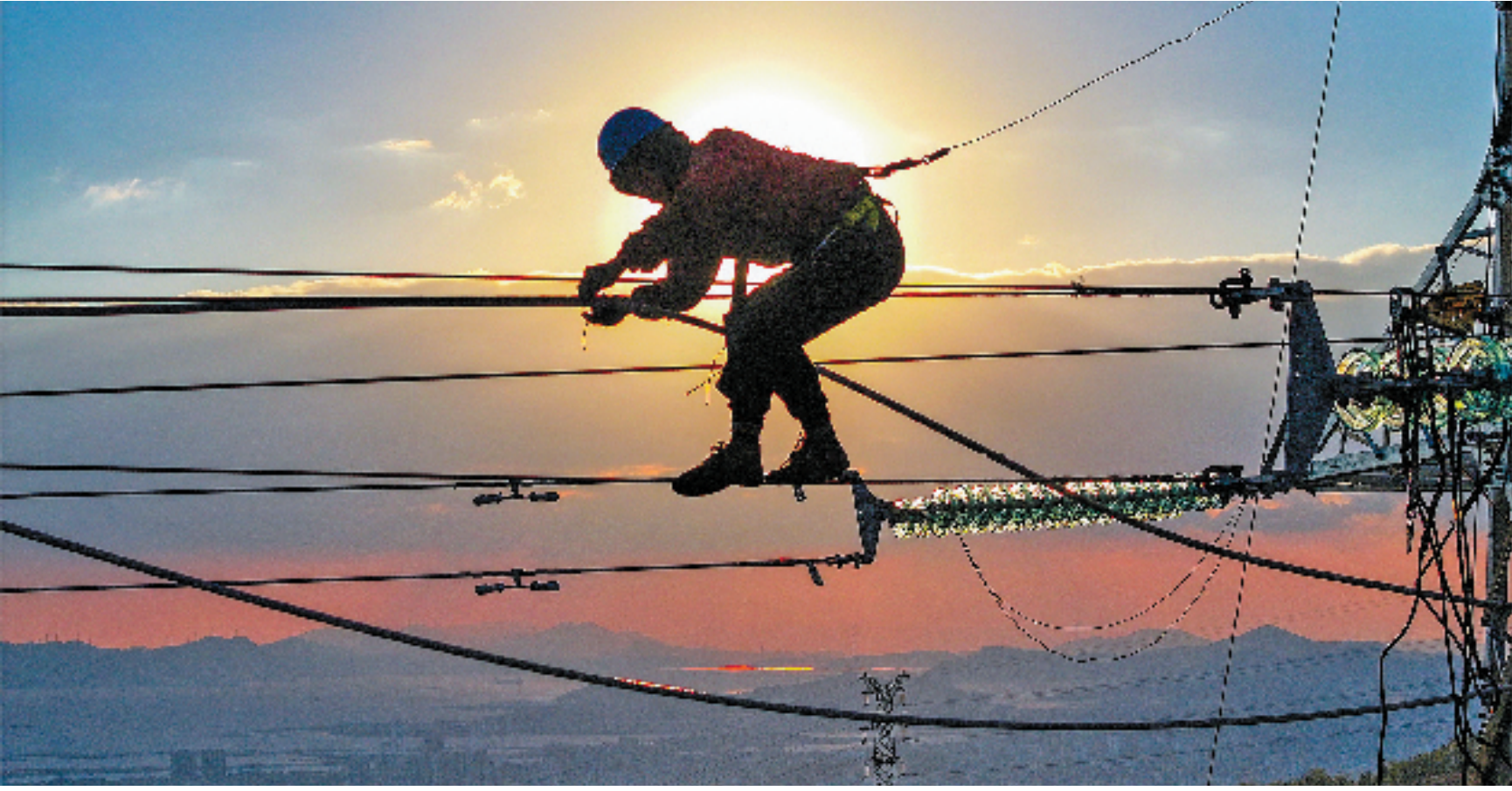
近日,国网舟山供电公司工作人员在舟山市普陀区青龙山顶组装输电塔。 姚峰 摄
